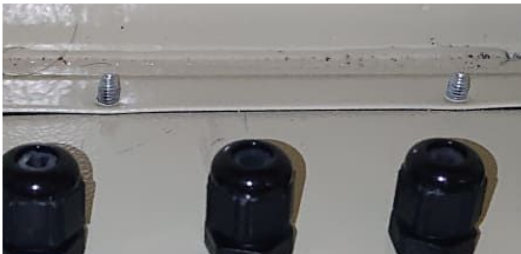
Figur 7.3. Lekkasje på monteringsplaten.
